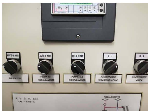
Figura 4.5 - Particolare del pannello di controllo di dell'impianto termico asservito ai locale della scuola
