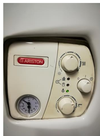
Figura 4.6 - Particolare del pannello di controllo di dell'impianto termico asservito ai locale della polizia municipale
