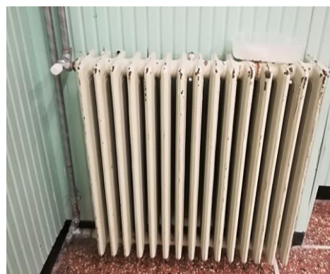
Figura 4.4 - Particolare dei radiatori installati sulle pareti esterne degli ambienti
